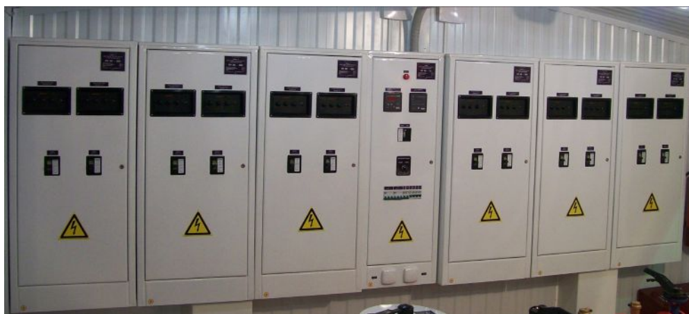
Рис. № 5. Пульты управления электрокотельной ЭК-1200БКм.
