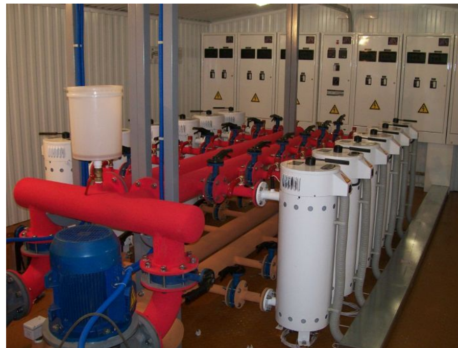
Рис. № 3. Электрокотельная ЭК-1200БКм. Вид изнутри.
