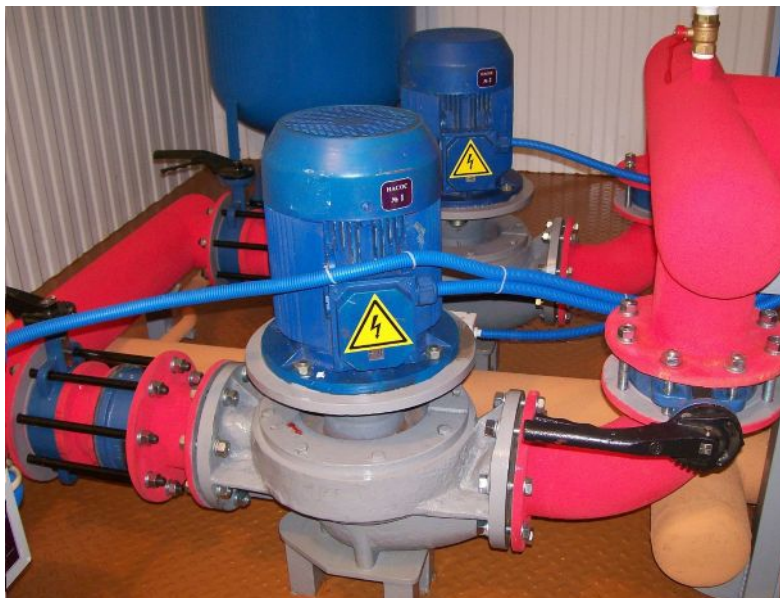
Рис. № 4. Блок электронасосов ЦНП-125/215.
