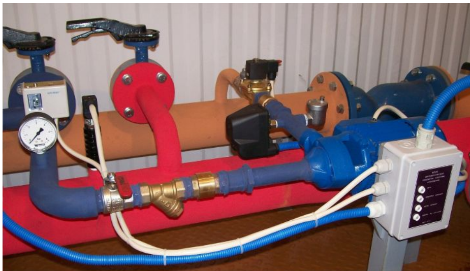
Рис. № 12. Узел автоматической подпитки системы отопления.
