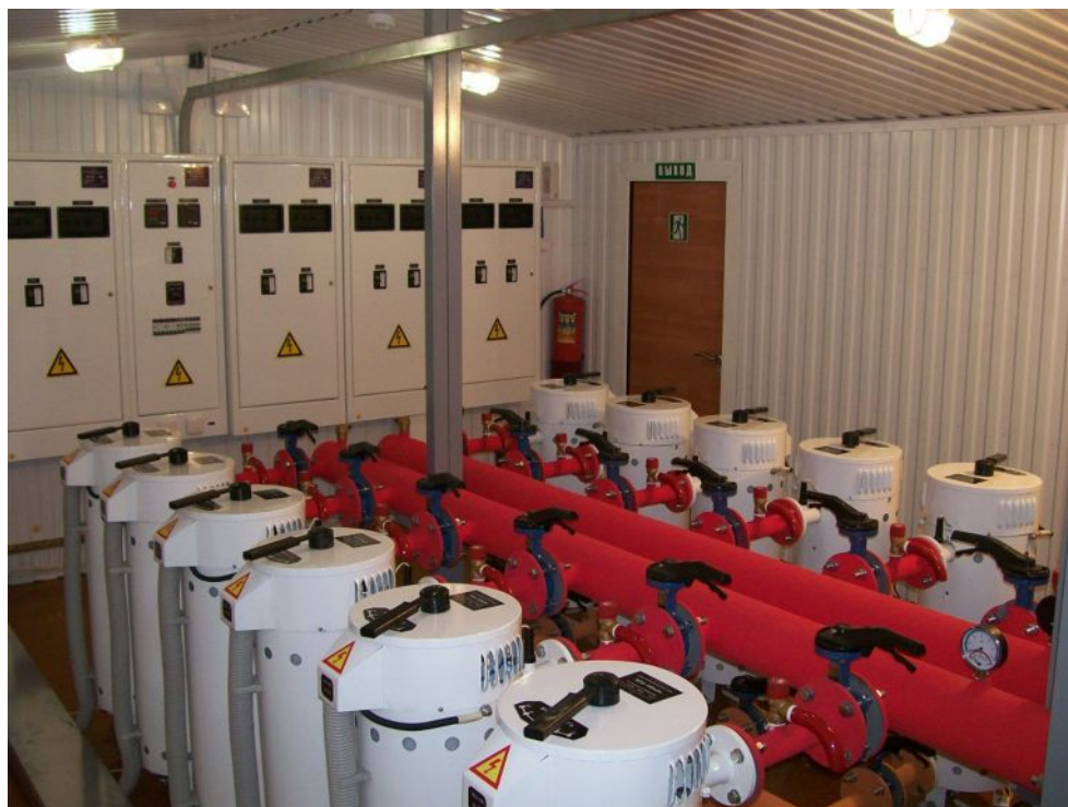
Рис. № 2. Электрокотельная ЭК-1200БКм. Вид изнутри.
